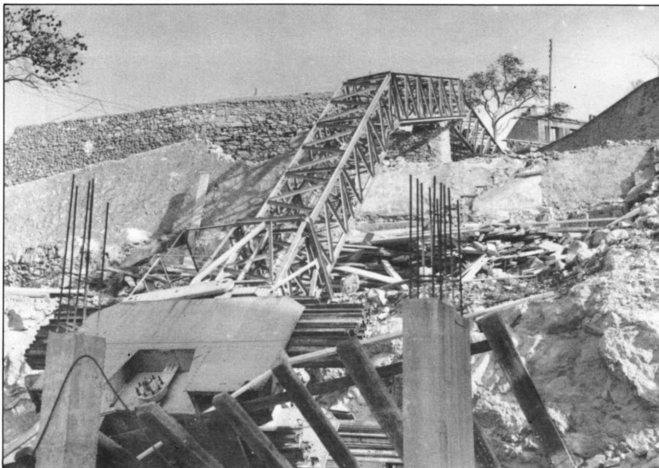
Chute d'une grue.
